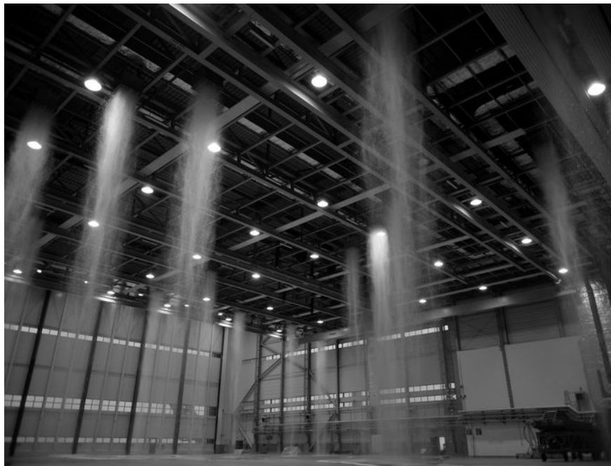
Foto: Flugzeughangar auf der US Air Base Ramstein, der sich mit Löschschaum füllt. In einem unterirdischen Auffangbecken wird der abfließende Löschschaum gesammelt, damit er anschließend in kontrollierten Mengen in eine Kläranlage entsorgt werden kann. Quelle: www.ramstein.af.mil/News/Photos (Larissa Greatwood)
